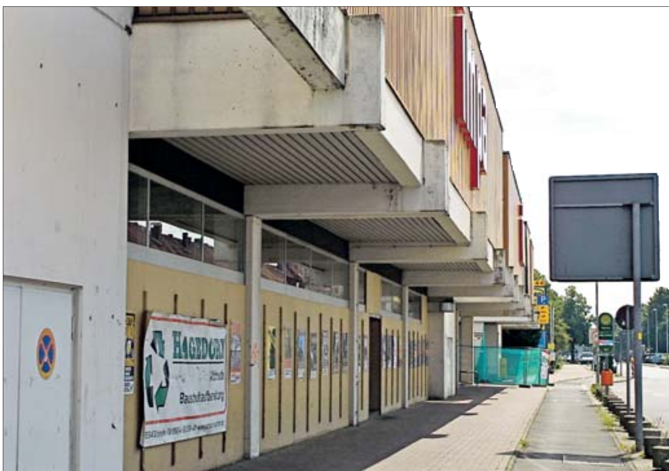
Der Gehweg vor dem früheren Yimpas-Markt ist völlig uneben.
